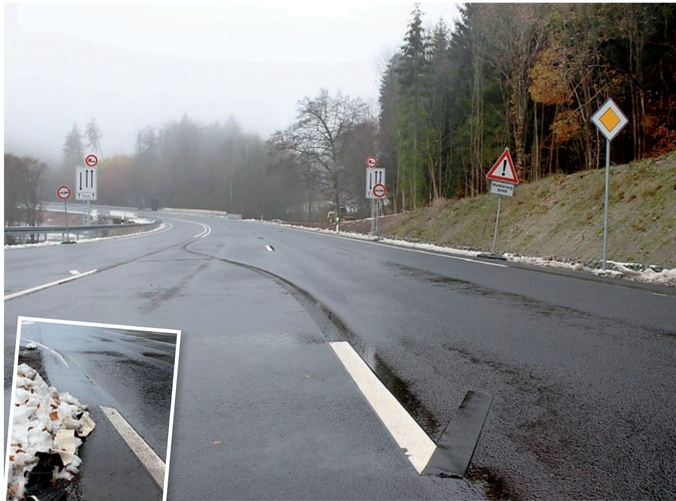
An mehreren Stellen hat sich die Fahrbahnmarkierung teilweise vom Untergrund der am Freitag freigegebenen B 253 an der Sackpfeife abgelöst und liegt herum. Fotos: Gianfranco Fain
