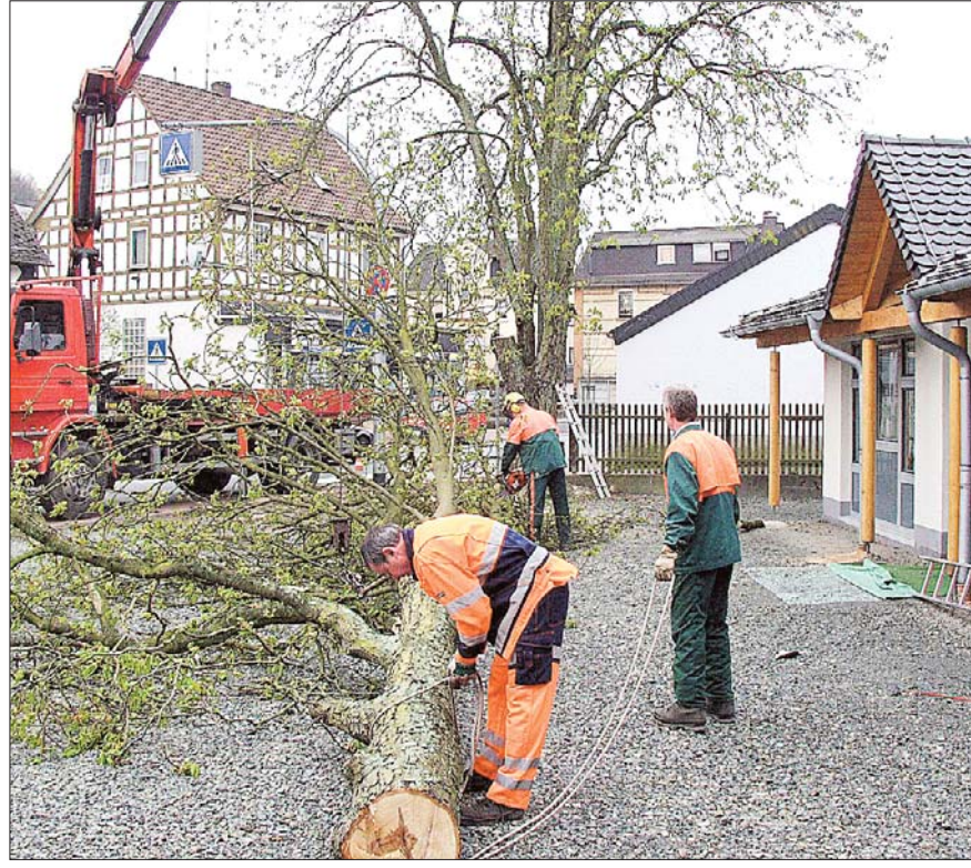
Der erste Ast der Kastanie am Hartenroder Dorfzentrum ist gefallen. Mitarbeiter des gemeindlichen Bauhofs zerlegen ihn. Foto: Klaus Peter
